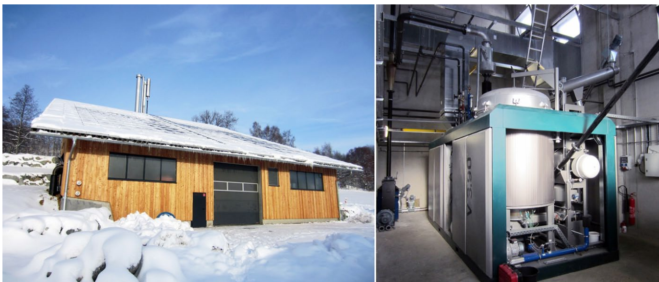
Landschaftlich integriertes Heizhaus in Wunsiedel mit Burkhardt Holzvergaser und BHKW in Kooperation mit der eta Energieberatung GbR aus Pfaffenhofen.
