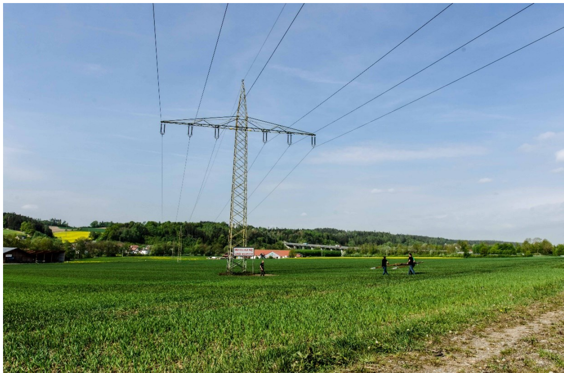
Abbildung 2: Das Stromnetz als "Rückgrat der Energiewende", Freileitung im Norden von Altdorf; Bildquelle: Simon Köppl
