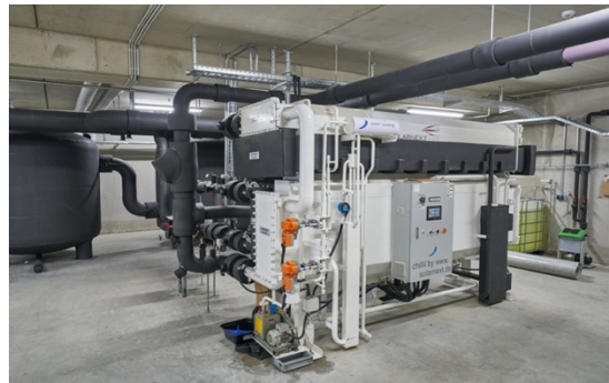
Abb. 2: Installierte Absorptionskälteanlage „chillii® Cooling Kit“ der SolarNext AG (Foto: Stadtwerke Rosenheim)
