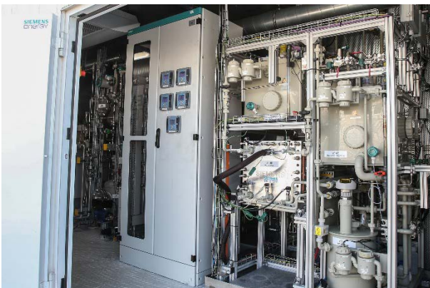
Siemens Energy CO-Elektrolyseur in der Versuchsanlage in Marl (Bild: Evonik/Debo)
