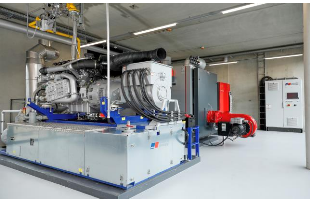
Bild 2_Blick in die Energiezentrale Alois Müller GmbH | Marco Lambart
