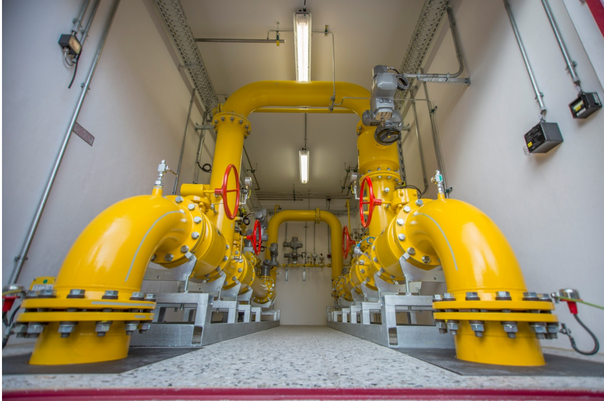
Abb.2: Einspeisepunkt für das umweltfreundliche Gas die GDRM-Anlage
