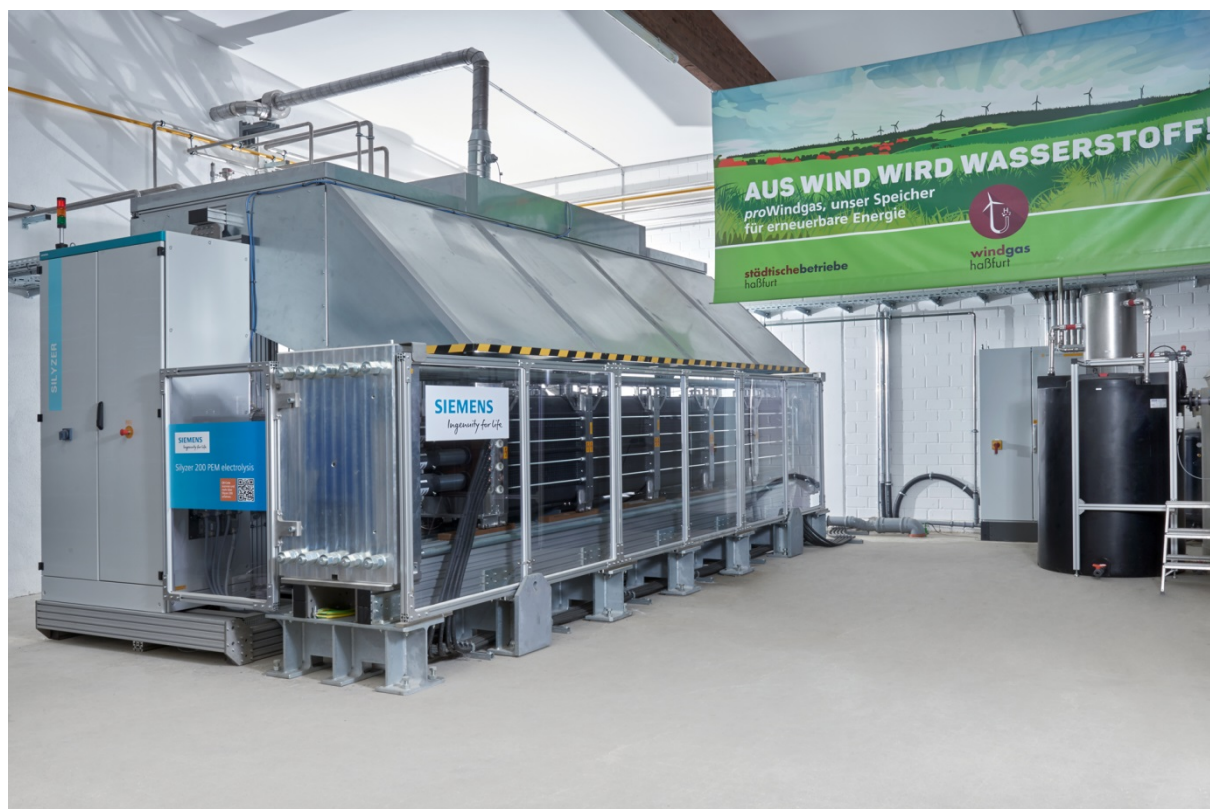
Abb.1: Herzstück der Power-to-Gas-Anlage der PEM-Elektrolyseur mit 1,25 MWel Anschlussleistung
